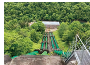
苫小牧工場が所有する千歳第一水力発電所
