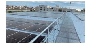
王子ネピア江戸川倉庫の太陽光パネル
