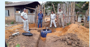
流域農家の土地へ寄贈した浄化槽
